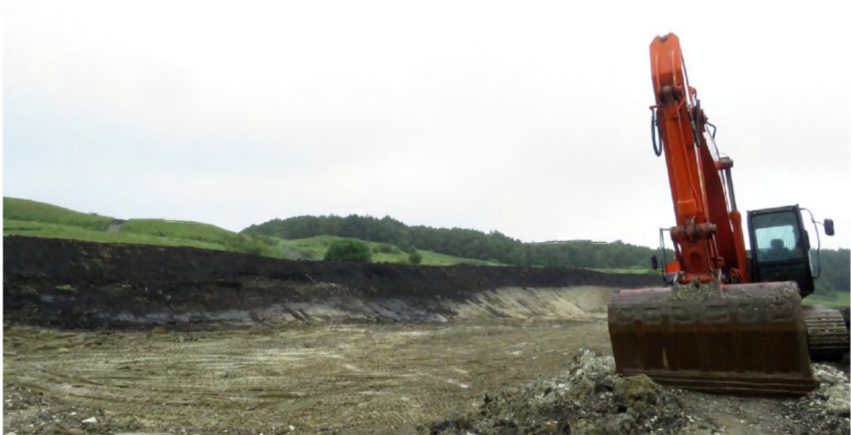
Рисунок 3 – Уничтожение местообитаний тритона Ланца в ходе реконструкции автодороги близ границ национального парка «Кисловодский», 28.07.2021
